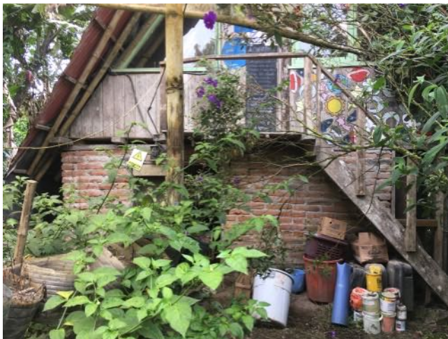
Dieses Gebäude, das uns gerade nur noch als Abstellraum und Werkstatt dient, ist einsturzgefährdet und wird abgerissen, um Platz für den Neubau zu schaffen.
