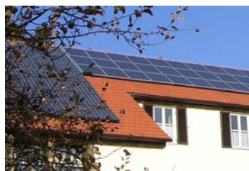
Photovoltaikanlage auf einem Gebäudedach in Stadsteinach
